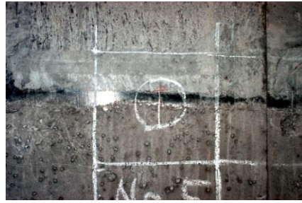
開口幅が大きいコールドジョイント 写真に示すような大規模なものは無いと言
