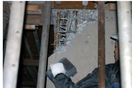
仕口部に生じた空洞
